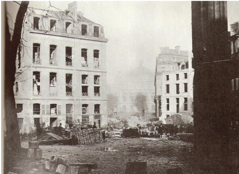
Image 11: Demolitions for the Avenue de l'Opéra. Garnier's Opéra sits in the background. Bibliothèque Historique de la Ville de Paris.
